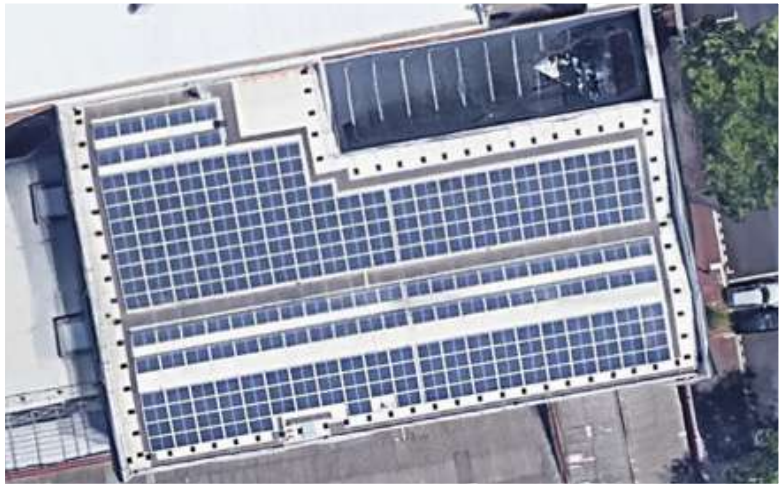
Figura 7.3. Instal·lació d'autoconsum amb els mòduls al vessant nord orientats al sud.
