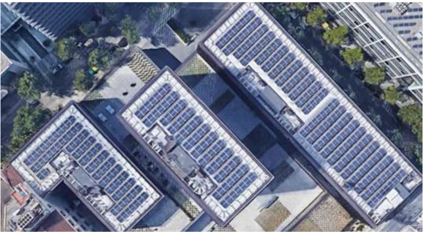
Figura 7.6. Instal·lació d'autoconsum amb doble orientació.
